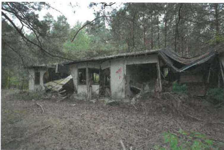
Exemplarisch abrisssreife Gebäude
