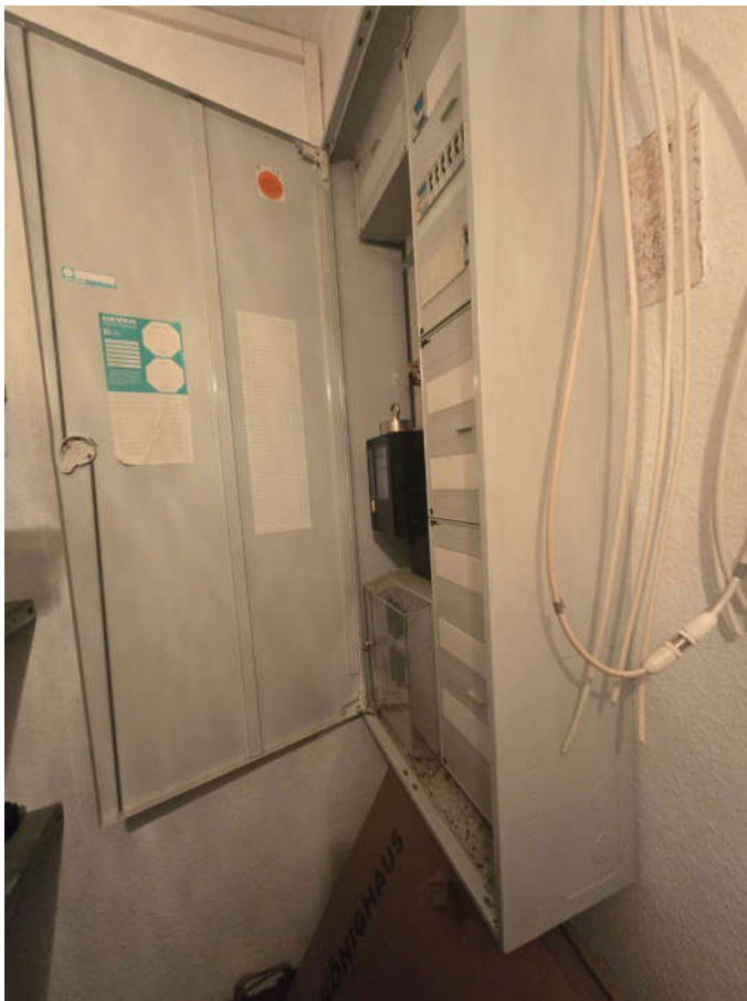
↑ Bild 8: erneuerter Elektroverteilerkasten
