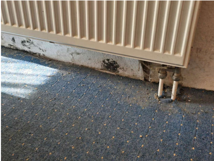
↑ Bild 11: Feuchteschäden an der Außenwand des Schlafzimmers
