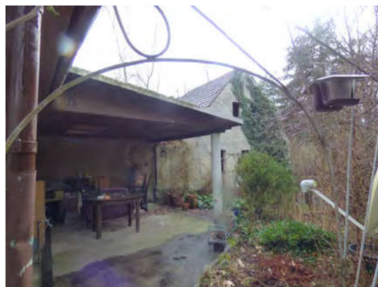
Fotos 4: Straßenansicht Freisitz am Garagennebengebäude und Blick auf ruiniertes Nebengebäude (Giebelseite)
