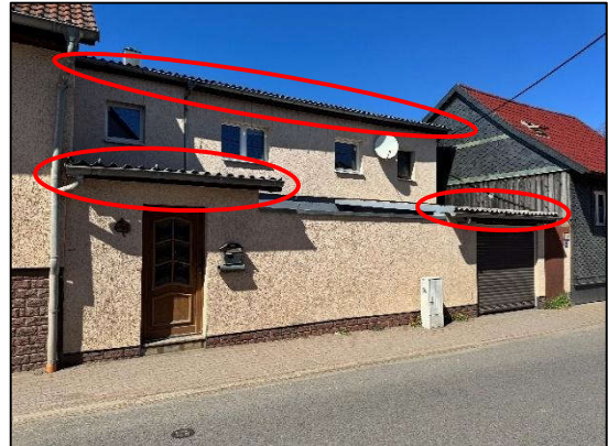
Straßenansicht - Anbau sowie Eingangsbereich und Garage mit Asbestdächern
