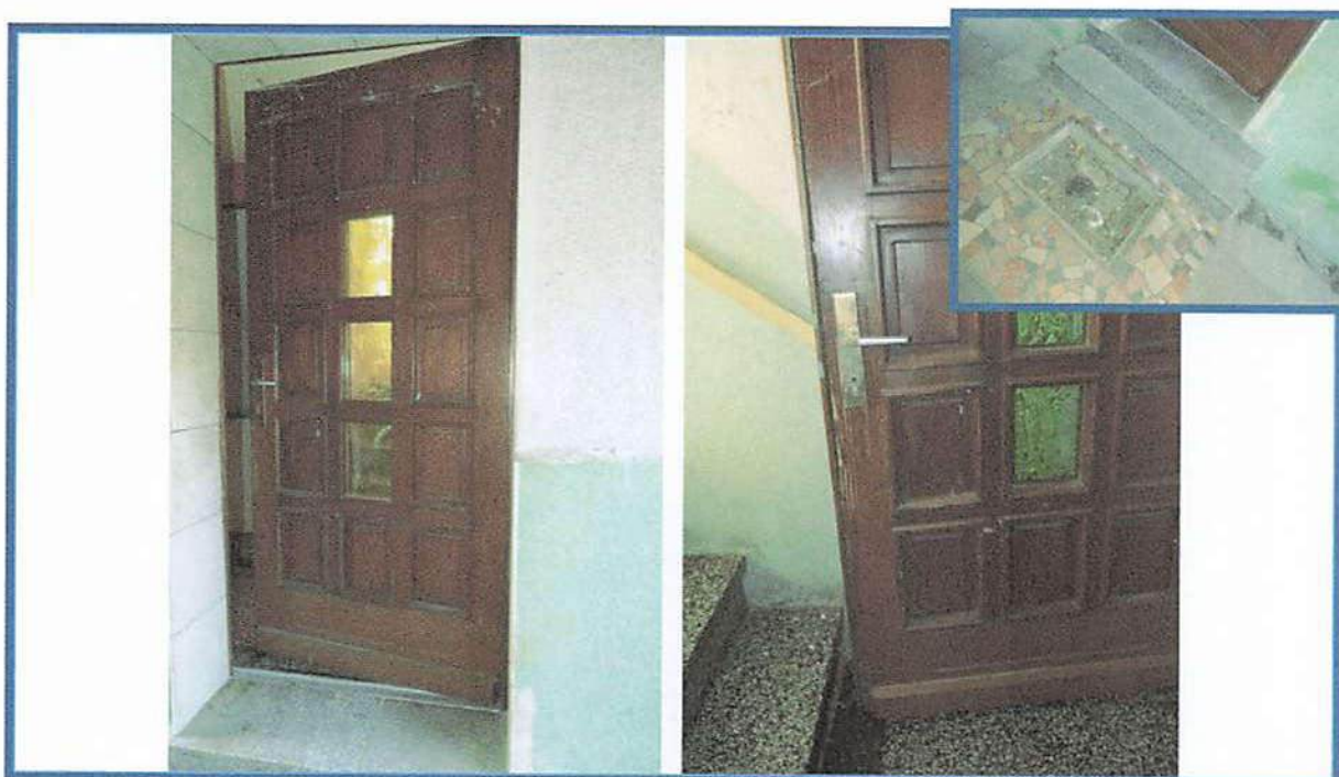
Abbildung 6: Hauseingangsbereich (tlw. beschädigt und vernachlässigt)
