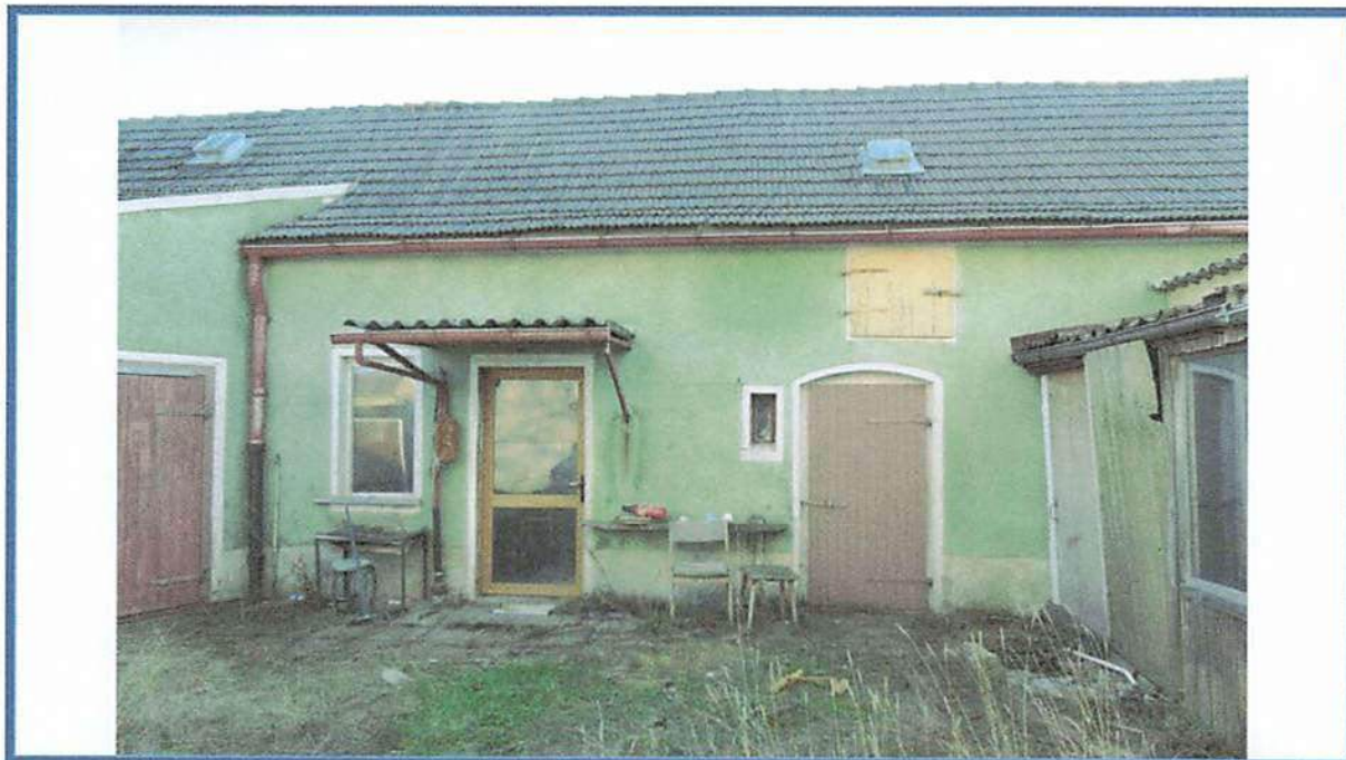
Abbildung 27: Mehrzweckgebäude mit integrierter Garage; verwilderte Außenanlagen im Innenhof (Flurstück 1/1)
